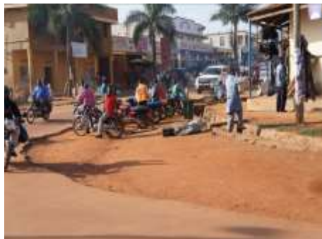
舗装部分が見事にはぎ取られた市内道路の一部
