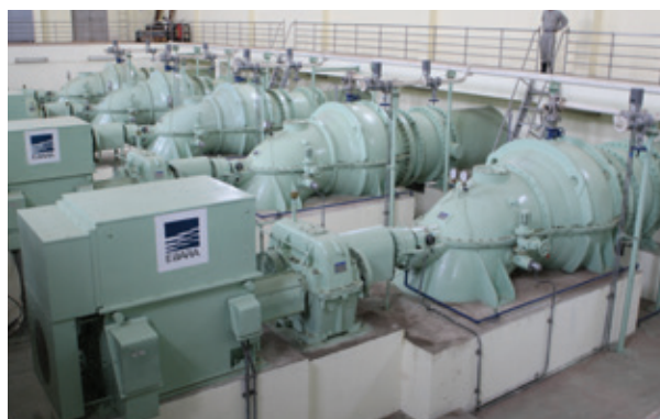
Trạm bơm Yên Sở
