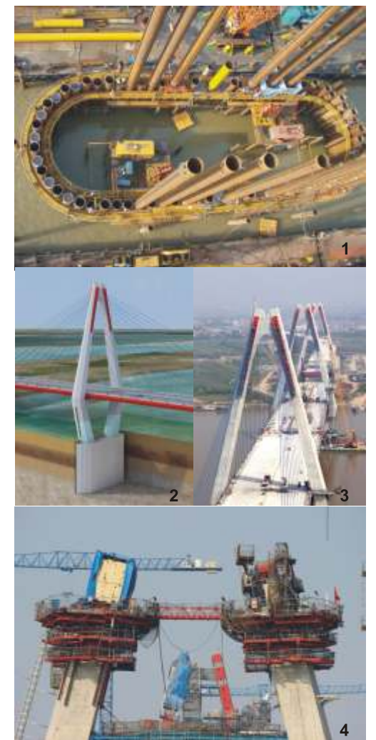
1 日本から調達された直径1.2m、118本の鋼管矢板が打ち込まれた小判型の主塔基礎 2 鋼管矢板井筒基礎は設置面積が少なく、往来する船舶交通の阻害も最小限に抑えられる 3 各主塔からバランスをとりながら架設。 6径間連続橋では、閉合に高度な技術が求められる 4 主塔上部を作業中のセルフクライミング式作業床
