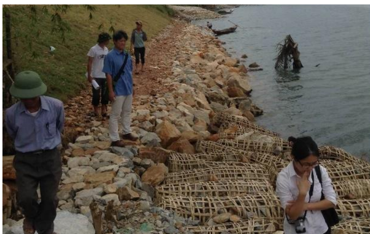
Dự án xây dựng kè bảo vệ bờ hữu sông Rào Nan - Quảng Bình
