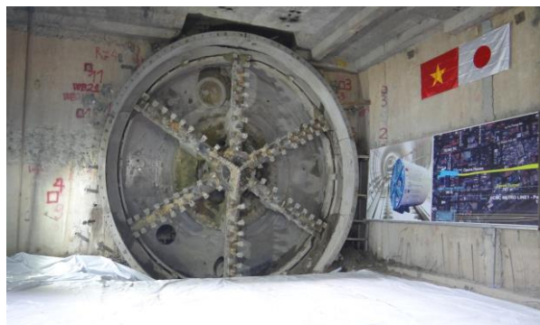
Nhánh hầm thứ hai của tuyến metro số 1 đã chính thức hoàn thành ngày 29/6/2018 (Ảnh do Liên danh nhà thầu Shimizu-Maeda cung cấp)
