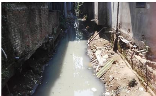
Hình ảnh cống nước thải lạc hậu tại Hà Nội
