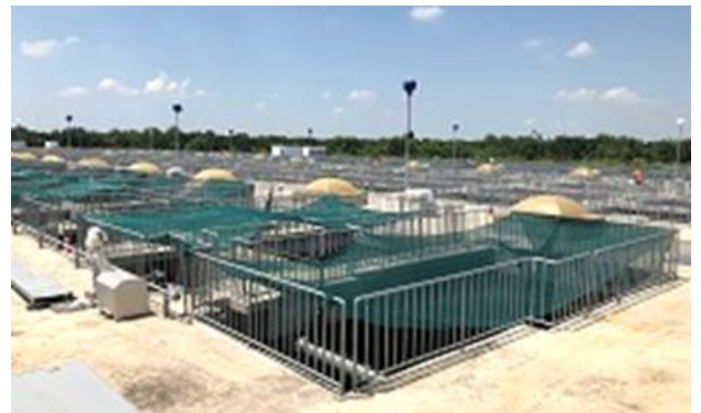
Nhà máy xử lý nước thải
